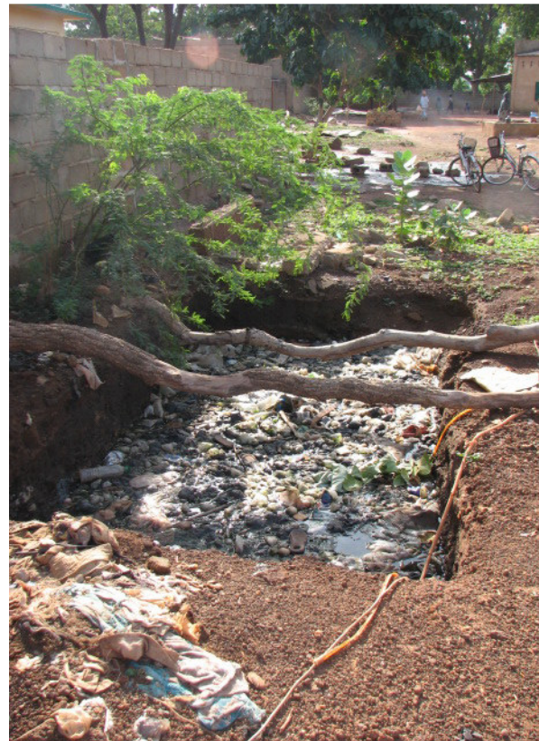
Photo 45 : Site de stockage intermédiaire de la grande mosquée (pour raisons similaires comme au CHR). Il était prévu de mettre encore une dalle, mais après l'argent ne suffisait pas.
