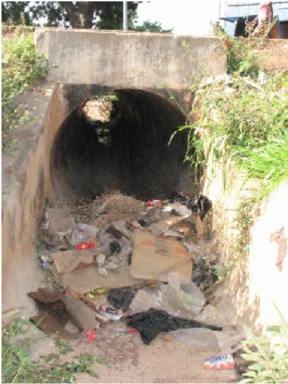
Photo 14 : Canal d'évacuation des eaux pluviales longeant la RN4 remplis avec des déchets ménagers.
