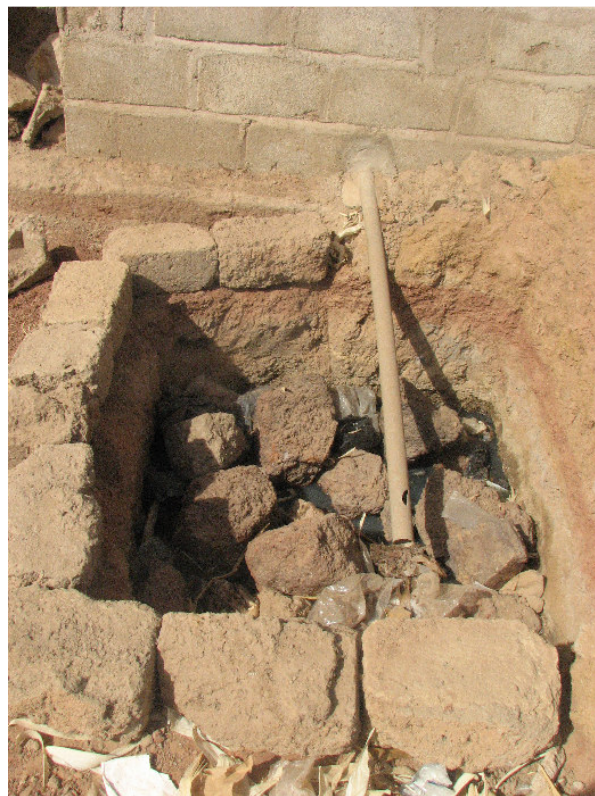
Photo 19 : Construction d'un puit perdu à côté de la cour pour mieux éliminer les eaux ménagères.
