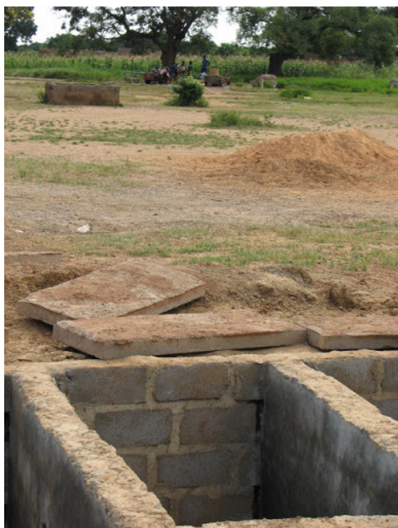
Photo 22 : Les fosses de latrines construites simplement en terre ou avec des perforations des murs causent des contaminations en azote de la nappe phréatique.
