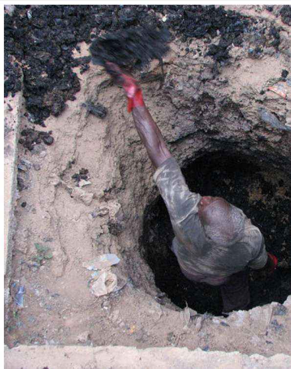
Photo 23 : Les gazes nocives et les objets coupants mettent gravement en danger la santé des vidangeurs - surtout de ceux qui pratiquent la manière manuelle.
