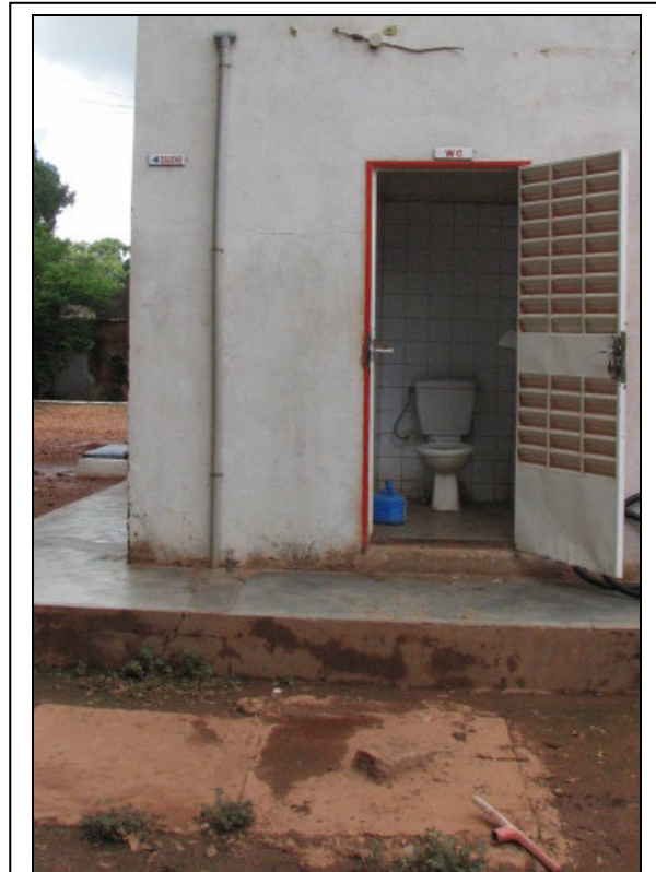
Photo 28 : Toilette à chasse manuelle avec la dalle de la fosse de stockage et le tuyau de ventilation sur la côté de la porte d'entrée (plus fréquemment, les deux installations se trouvent sur la côté arrière de la construction).
