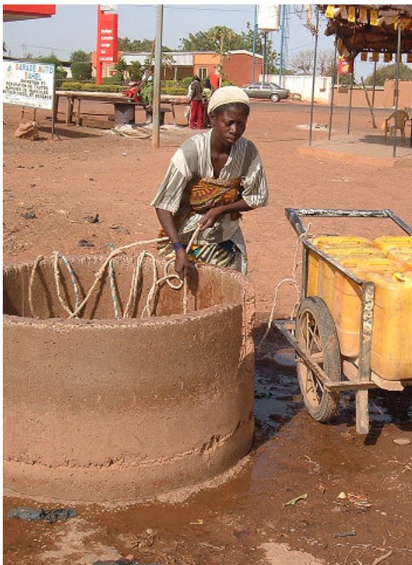
Photo 4 : Puits moderne busé.
