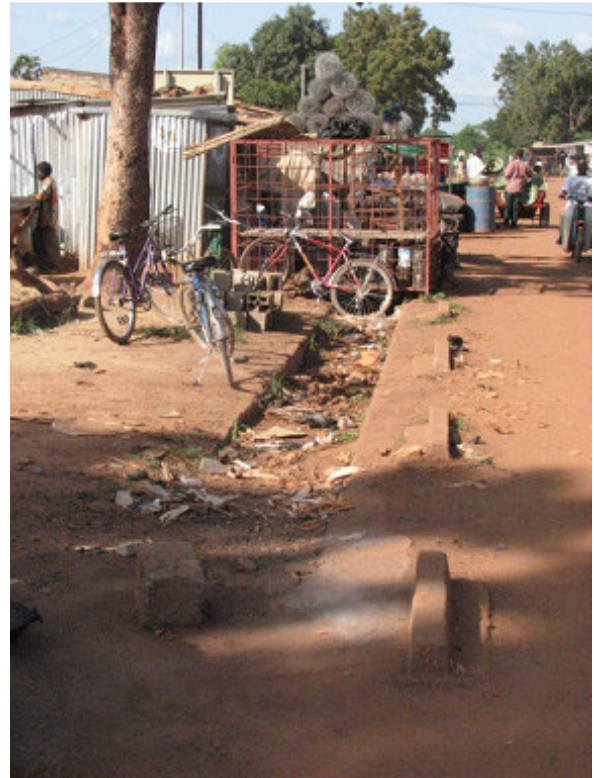
Photo 15 : Canal d'évacuation des eaux pluviales à côté du marché central remplis avec des déchets du marché.
