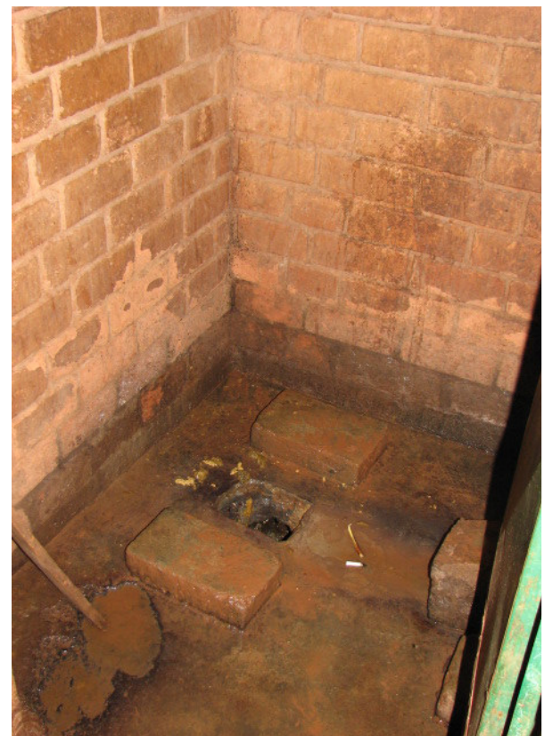
Photo 35 : Une latrine d'un bloc de latrine moyennement maintenue.
