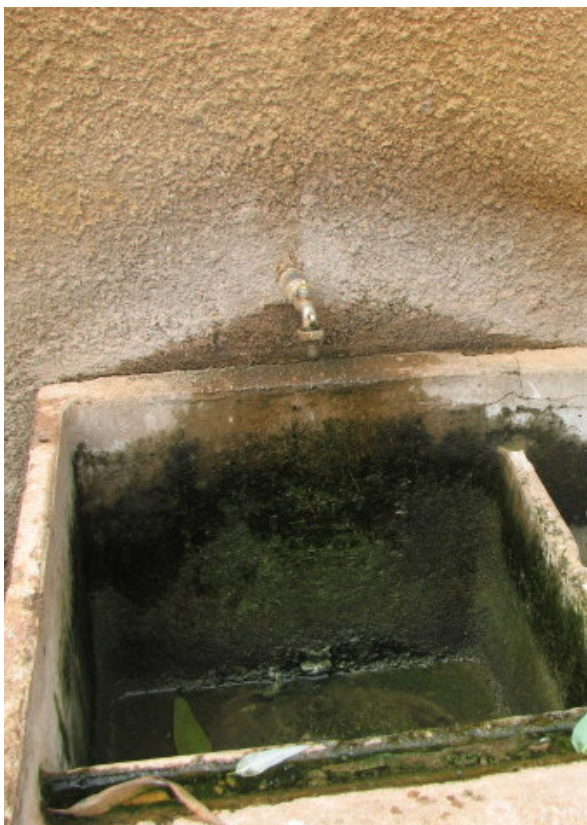
Photo 32 : Robinet infonctionnel à côté des latrines publiques au CHR.
